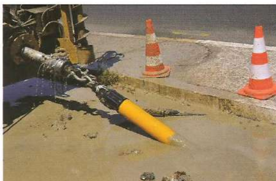
Fuoriuscita del tubo in polietilene presso il pozzo di arrivo
